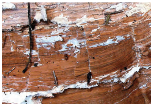
Fot. 112. Żółciak powoduje intensywną zgniliznę brunatną twardzieli, później bieli z pryzmatycznymi spękaniami drewna, w tym także budowlanego (podwaliny), poprzerastanego płatami białej, skórzastej grzybni
