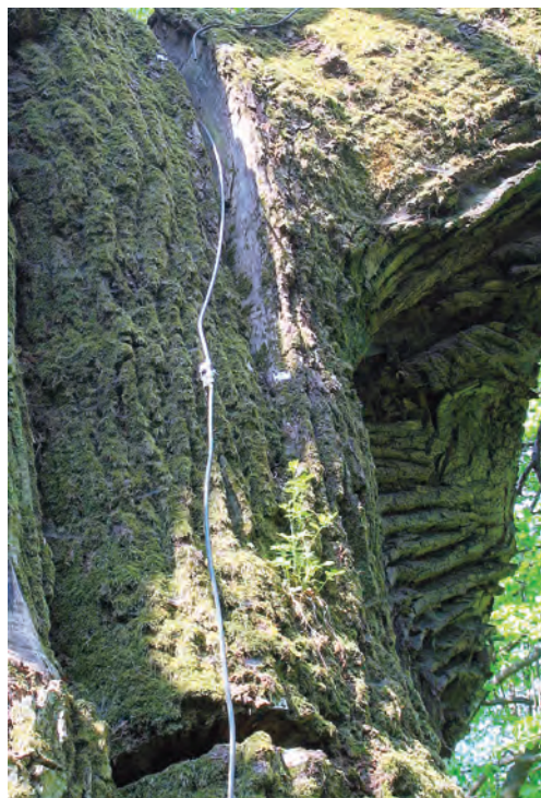
Fot. 199. Pęknięcie nasady dolnego konara północnego
